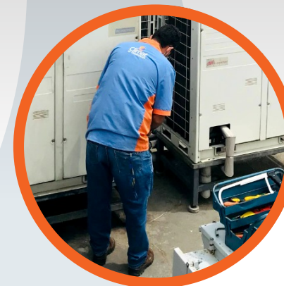
Manutenção de Ar Condicionado
